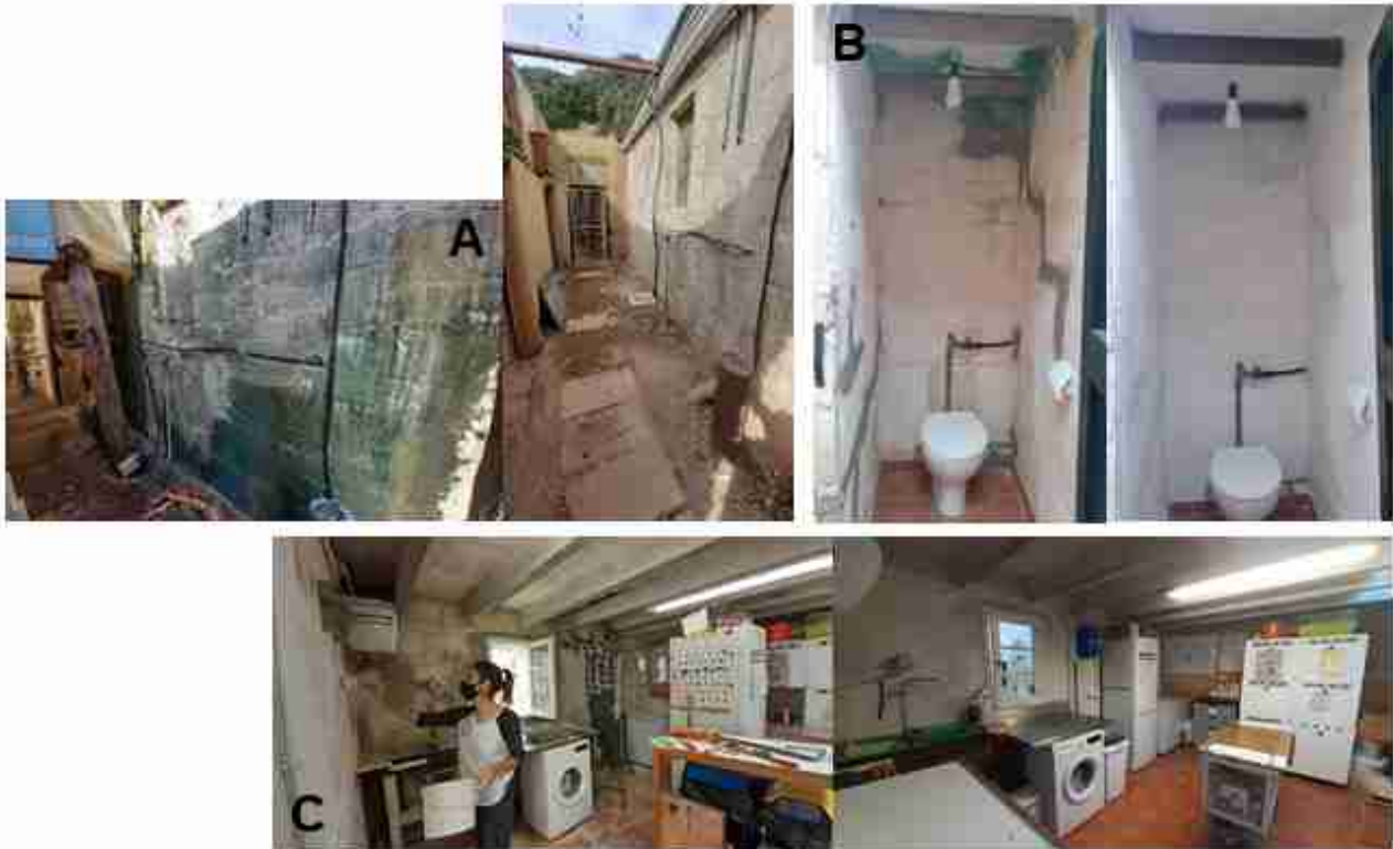
Figura 38. Millores fetes durant el 2021. Les fotografies mostren l'estan previ i posterior de l'emblanquinat de les instal·lacions. La fotografia A) correspon a la paret externa de la caseta principal, la fotografia B) al lavabo i la fotografia C) a l'interior de la caseta principal.
